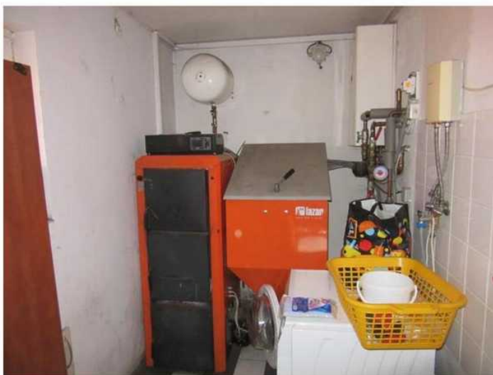
Pohled do interiéru penziónu - kotelna v přízemí
